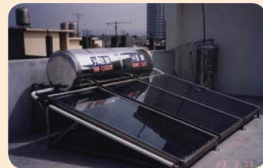
Riscaldatori d'acqua a pannelli solari, Taiwan, Cina.
