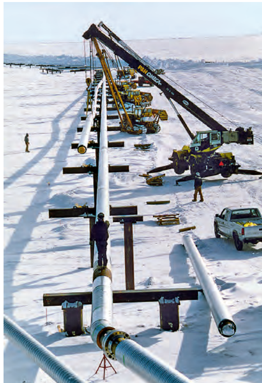
Verlegung isolierter 24-Zoll-Rohre aus dem Werkstoff EN 1.4462 (2205) auf vertikalen Stützen in Prudhoe Bay (Quelle: Arco Exploration and Production Technology)
