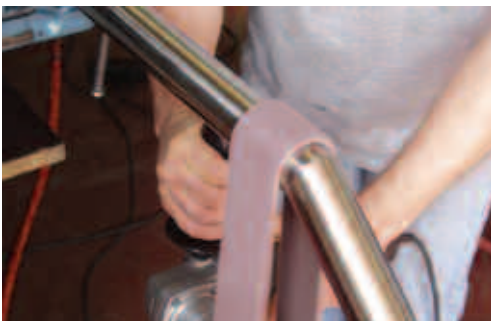
Opération de finition avec un outil électrique facile à utiliser. L'angle aigu du raccord est encore visible, avec la soudure entièrement homogénéisée à la surface.
