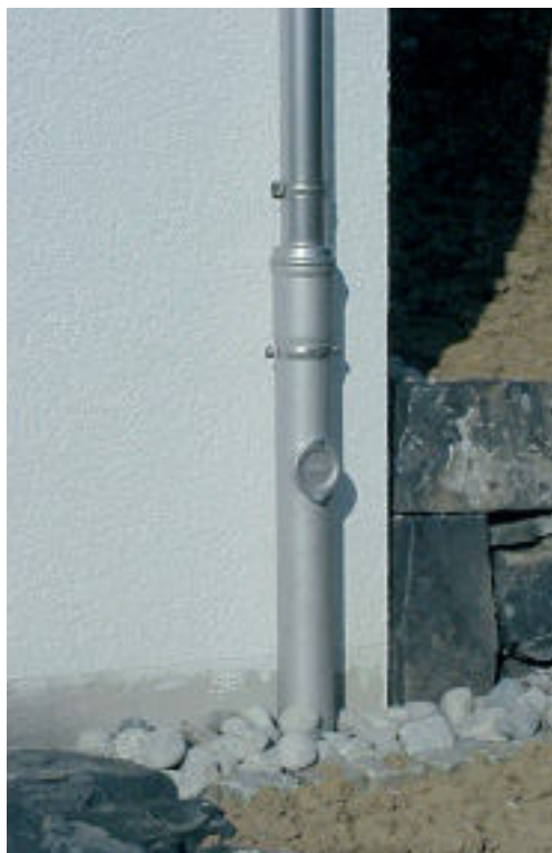
Pluviale con sportello d'ispezione.
