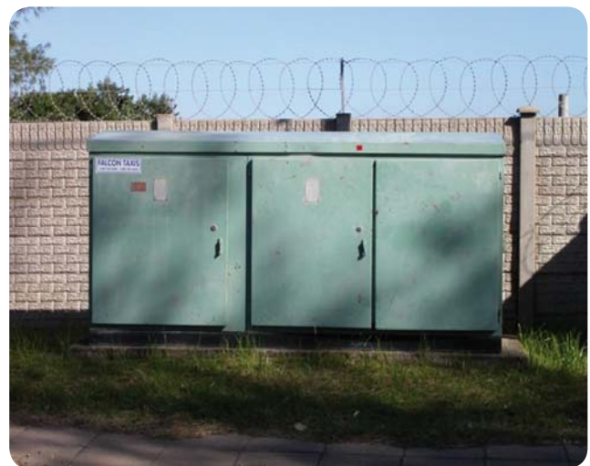
Stromverteilerkasten aus beschichtetem 1.4003 (410), Südafrika
